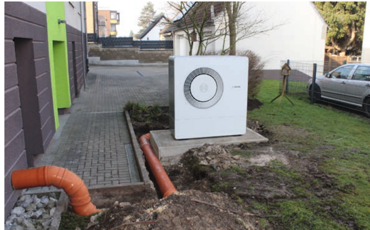
Wärmepumpen-Hybridanlagen als zukunftssichere Beheizungsart an unseren Häusern der Vödestraße.
